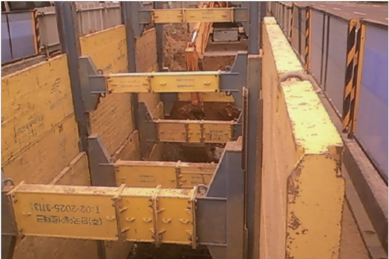
SBH DOUBLE SLIDE RAIL - 대치역 주변 침수방지 시설공사(이화종합건설)
