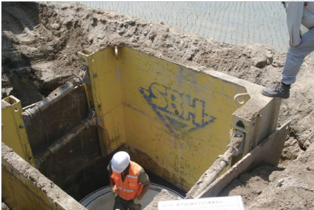
SBH MANHOLE BOX - 충주댐상류 하수관거 확충공사(현대건설)
